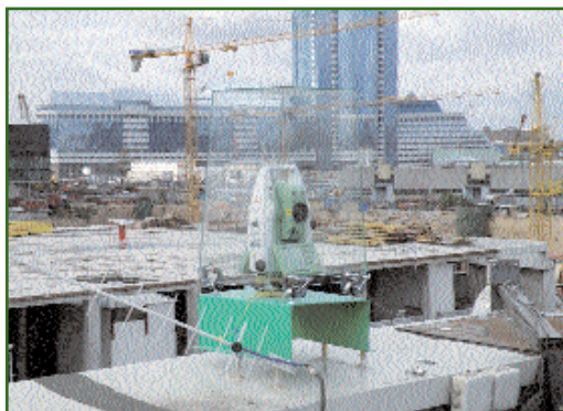
Рис. 6 Электронный тахеометр, установленный «Фирмой Г.Ф.К.» для автоматического контроля за смещениями высотного здания комплекса Москва-Сити
