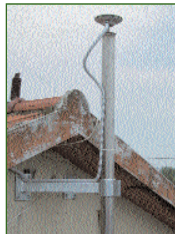
Рис. 2 Пример установки антенны спутникового приемника базовой станции на высокой мачте
